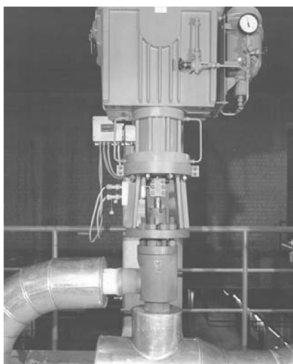
ZK213 - zawór regulacji minimalnego przepływu głównej pompy wody zasilającej z kompaktowym siłownikiem elektro-hydraulicznym
